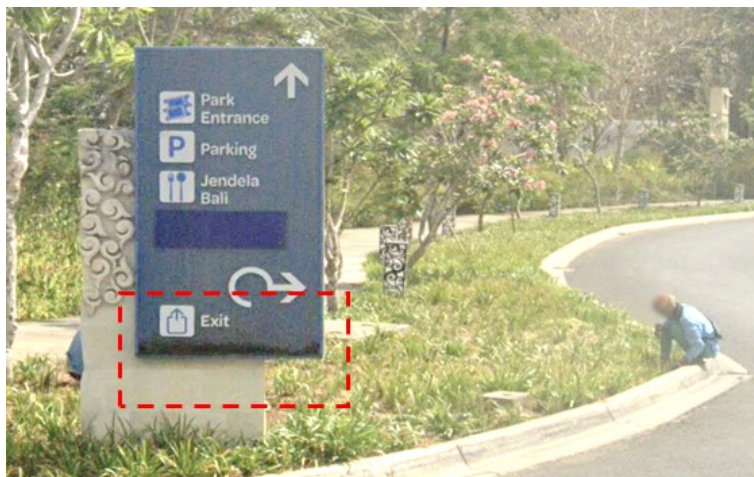
Gambar 1. Signage yang Korosi Akibat Kesalahan Pemilihan Material Sumber: Data Perusahaan, 2022
