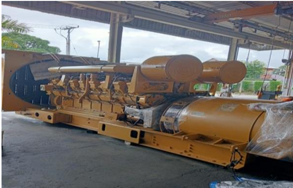
Gambar. 2 Mesin Generator Seri 3516
